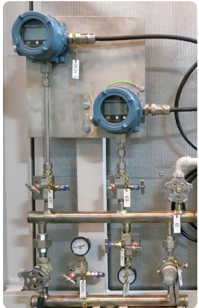
Monitoramento de pressão de vedação
