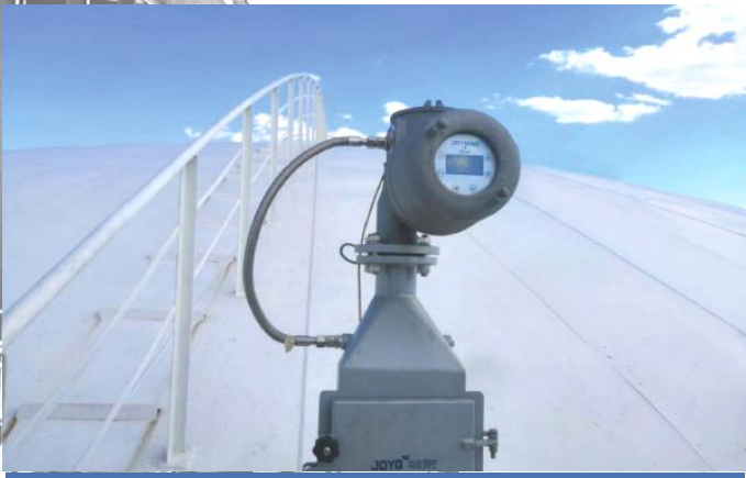
Sistema de medição de tanque P8
